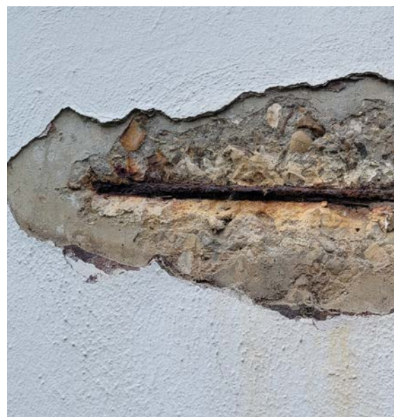
Éclats de béton
