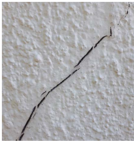
Lézardes DTU 20.1, pour les maçons
